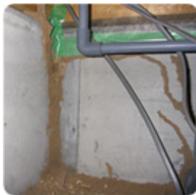
コンクリート部の蟻道
